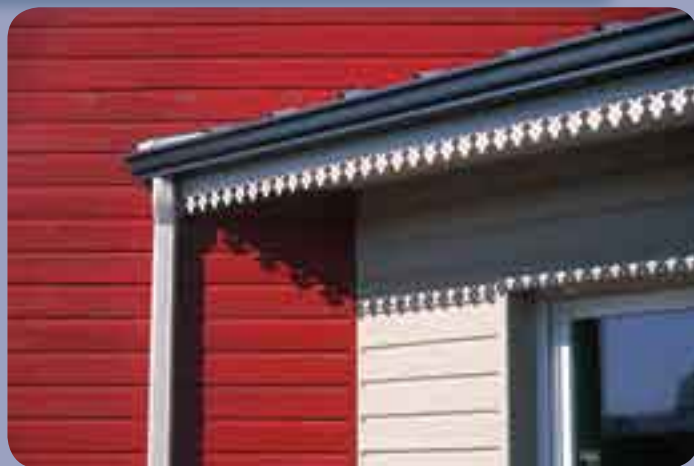
Silverwood EXTRA - Rouge Sang de Bœuf et Gris Beige - L. BOISSEAU, architecte DPLG.
